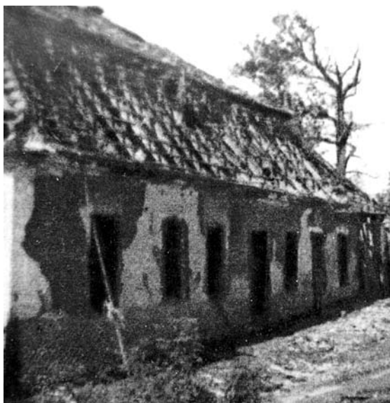
Foto z knihy: Jaromír Kotík, Velká Bíteš za okupace, 1965, str. 87. Nárožní dům čp. 95 po osvobození v roce 1945, nedlouho před zbouráním.
