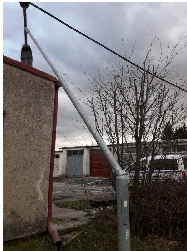
Obrázek 2 Poškozená lampa veřejného osvětlení - ul. K Mlýnům
